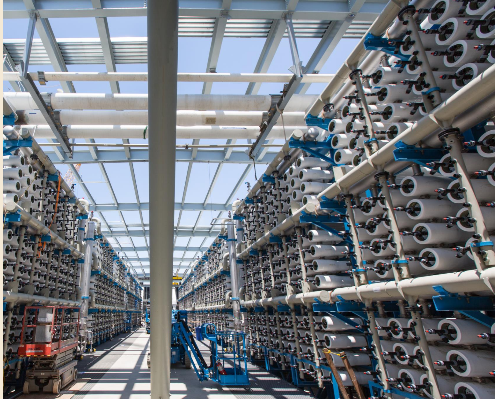
Foto: Planta desalinizadora de agua de mar, Claude "Bud" Lewis Carlsbad, CA, USA
